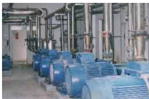
Station de Kerkennah (mise en service en 1983)
